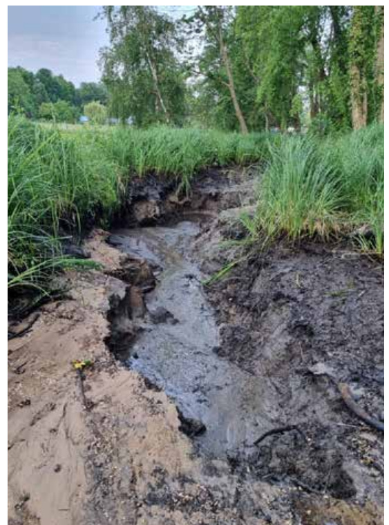
Wasserrückhalt in der Landschaft funktioniert nur mit funktionierenden Dämmen (Foto: K. Kretschmar)
